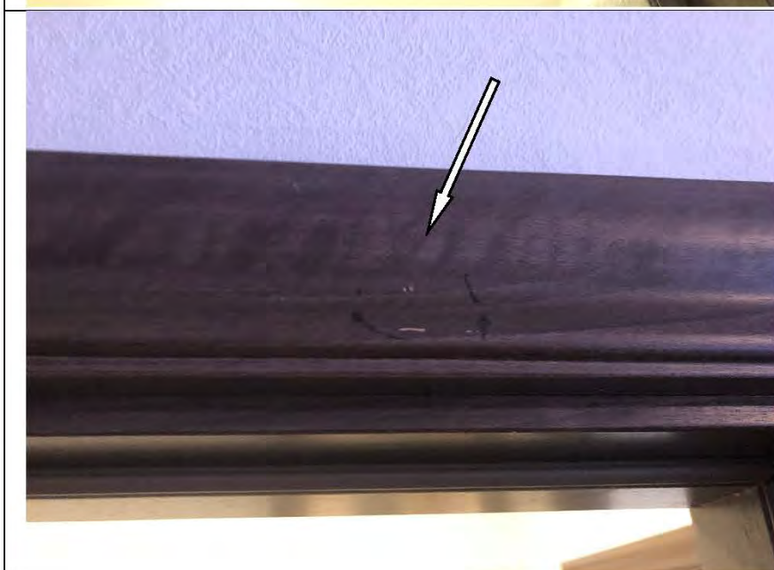
Фото №42. Царапины на наличниках деревянного дверного блока в спальне в квартире.
