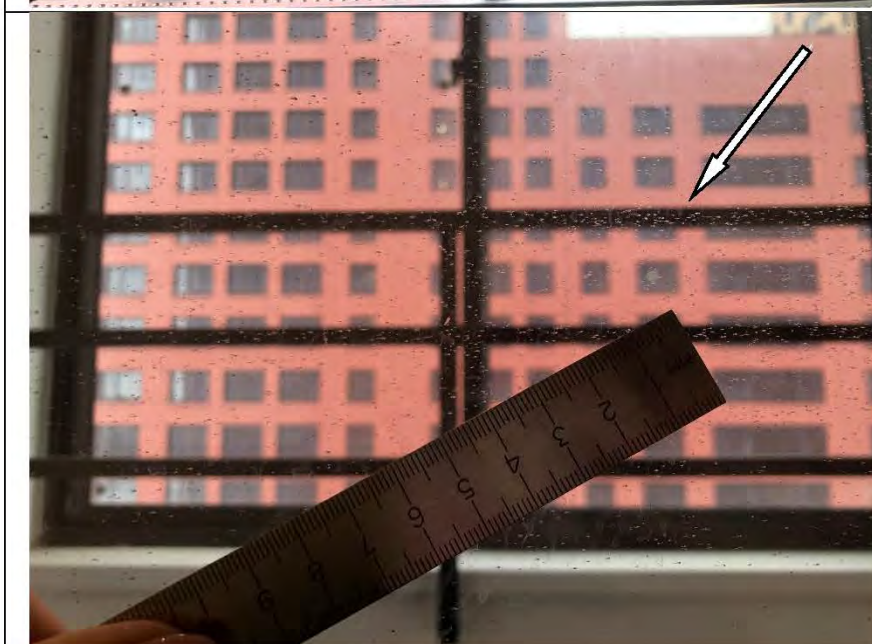
Фото №51. Окарины на стеклопакете дверного блока ПВХ в кухне в квартире.
