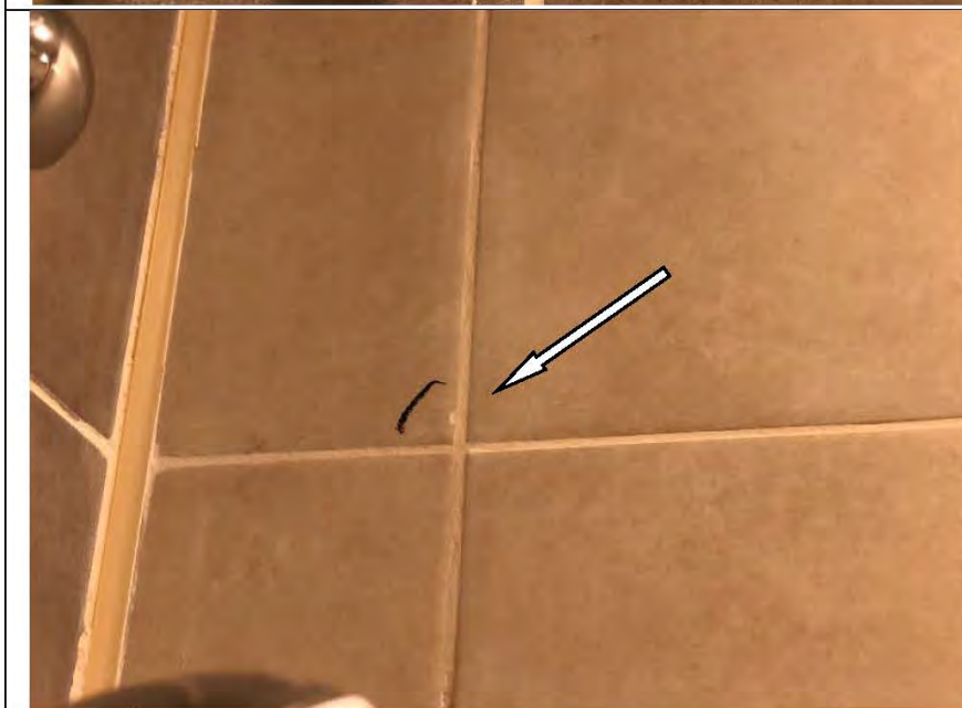
Фото №36. Сколы настенной керамической плитки в ванной комнате в квартире.
