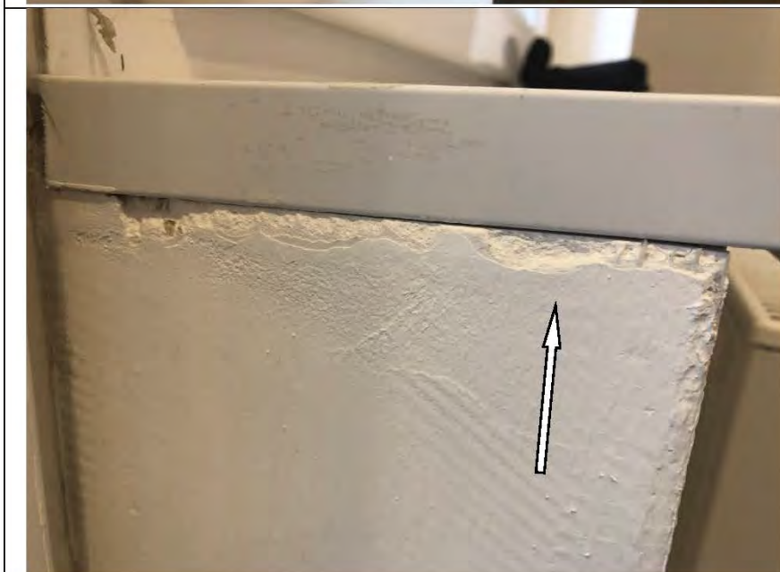
Фото №54. Дефект на откосах оконного блока ПВХ в кухне в квартире.
