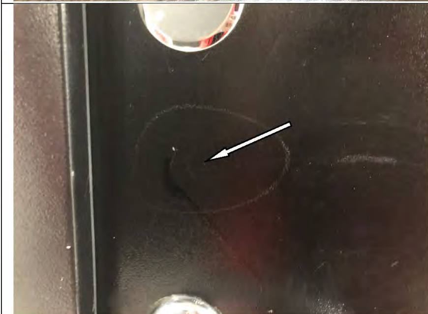
Фото №66. Царапины на полотне входного дверного блока.
