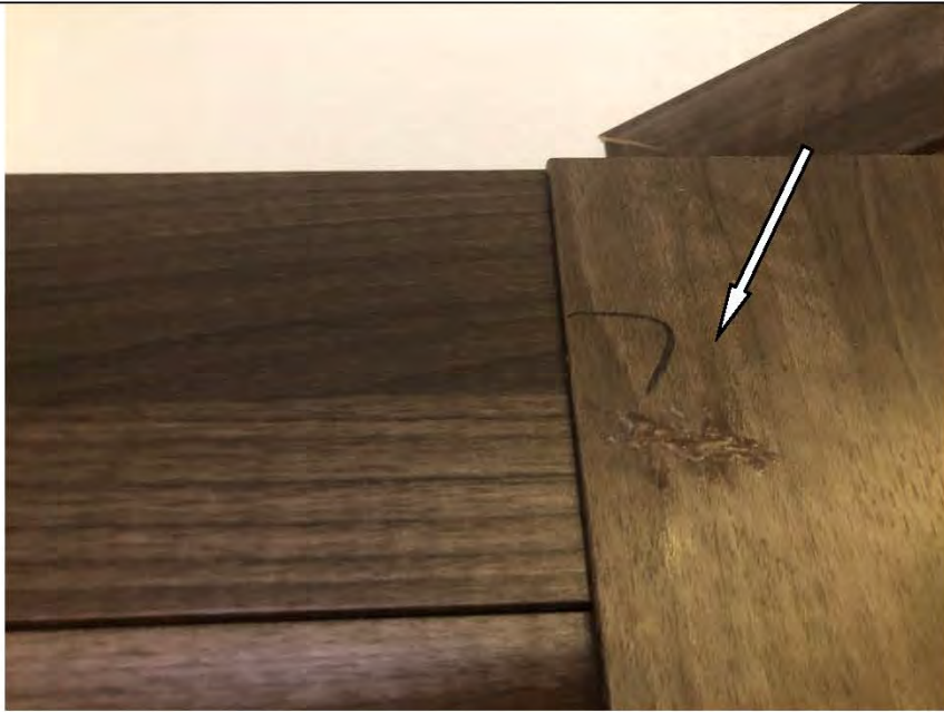
Фото №43. Дефект на полотне деревянного дверного блока в кухне в квартире.
