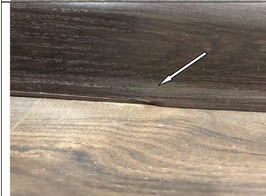
Фото №75. Замятие напольного плинтуса в спальне в квартире.
