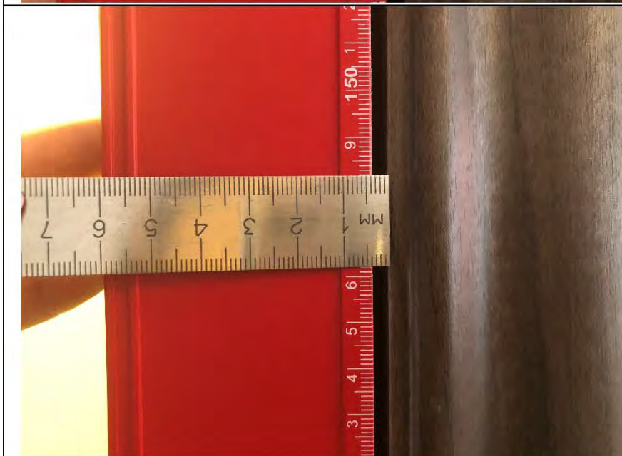
Фото №14. Отклонение наличника деревянного дверного блока в спальне в квартире.
