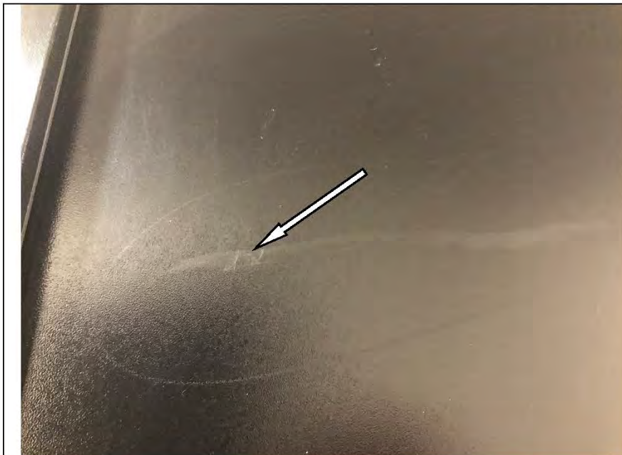
Фото №67. Царапины на полотне входного дверного блока.
