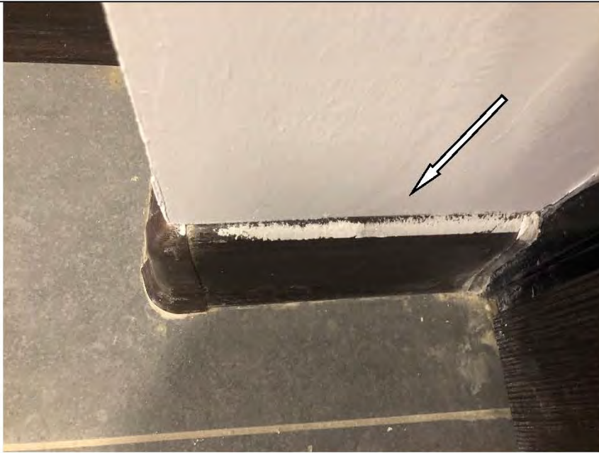
Фото №25. Загрязнение напольного плинтуса ПВХ в коридоре в квартире.
