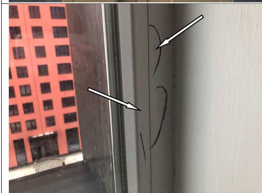
Фото №57. Дефект монтажа профиля оконного блока ПВХ в спальне в квартире.
