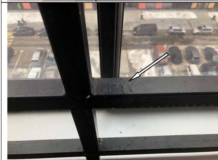
Фото №59. Потёки краски на решетке на лоджии в квартире.
