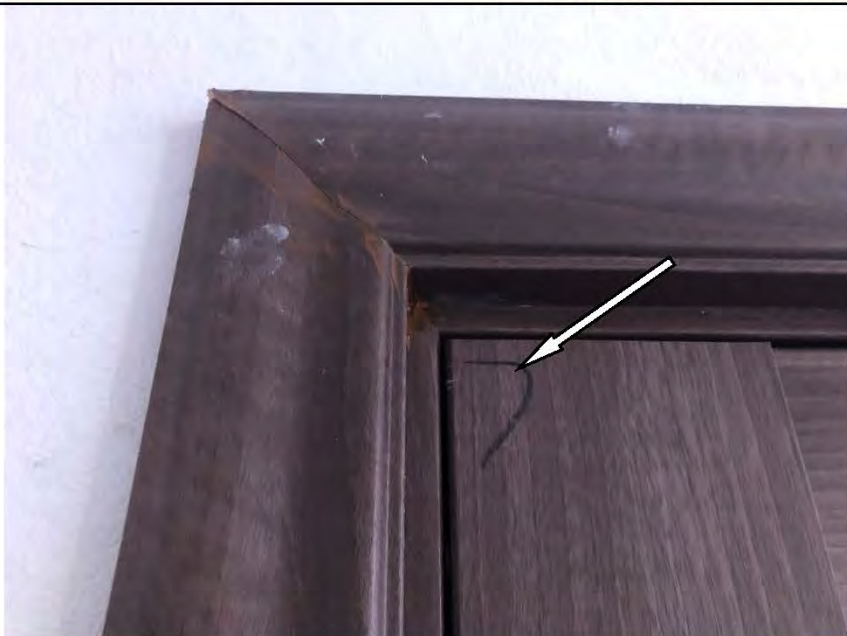
Фото №44. Дефект на полотне деревянного дверного блока в спальне в квартире.
