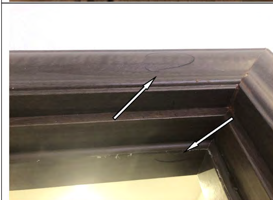
Фото №41. Царапины на коробке и наличниках деревянного дверного блока в кухне в квартире.
