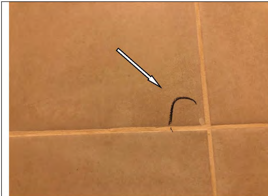
Фото №37. Сколы настенной керамической плитки в ванной комнате в квартире.
