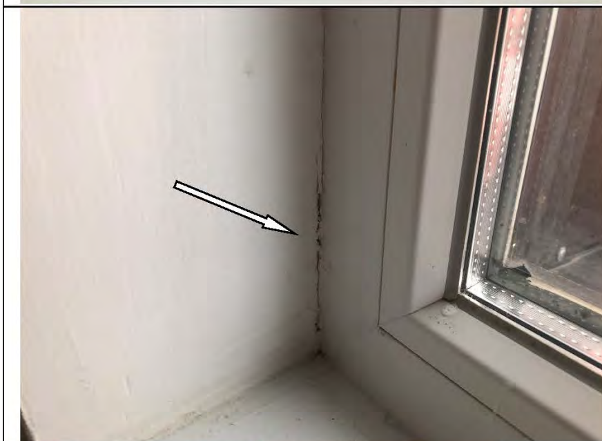
Фото №62. Трещина (щель) в месте примыкания оконного блока в спальне в квартире.
