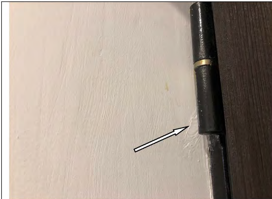
Фото №22. Неровности окраски на откосах входного дверного блока в квартире.
