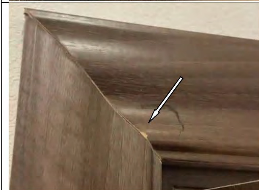
Фото №68. Царапины на наличника деревянного дверного блока в ванной комнате в квартире.
