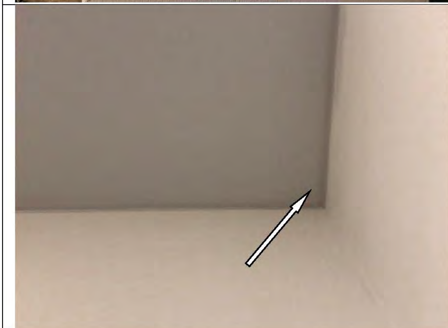
Фото №24. Загрязнение на полотне натяжного потолка в коридоре в квартире.
