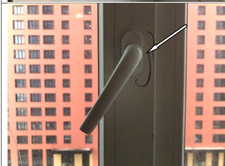
Фото №63. Дефект регулировки фурнитуры оконного блока ПВХ в спальне в квартире.
