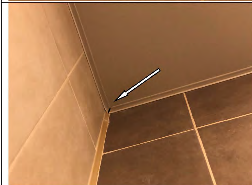
Фото №38. Дефект монтажа гибкой вставки натяжного потолка в ванной комнате в квартире.
