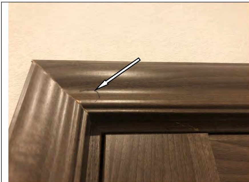
Фото №40. Царапины на коробке деревянного дверного блока в ванной комнате в квартире.
