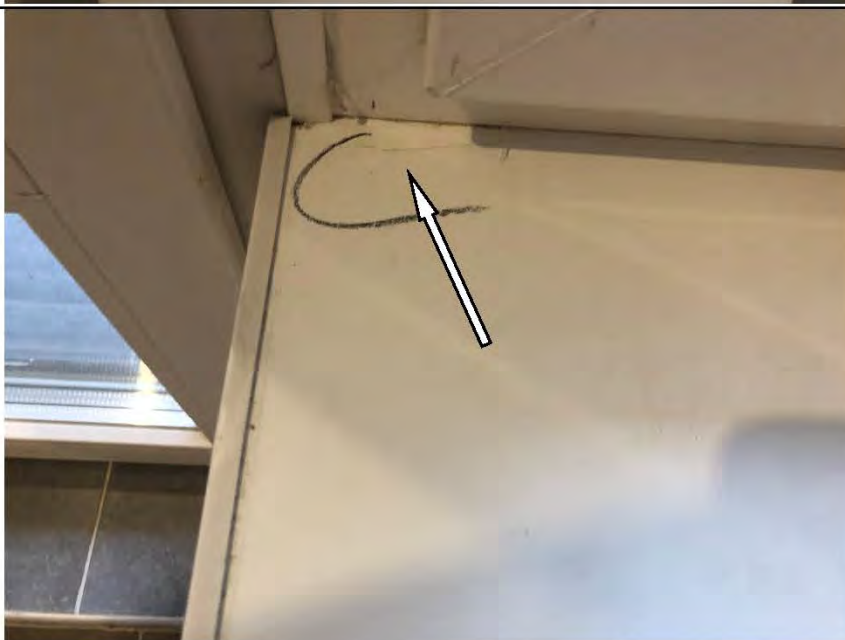
Фото №47. Царапины на подоконной доске в кухне в квартире.
