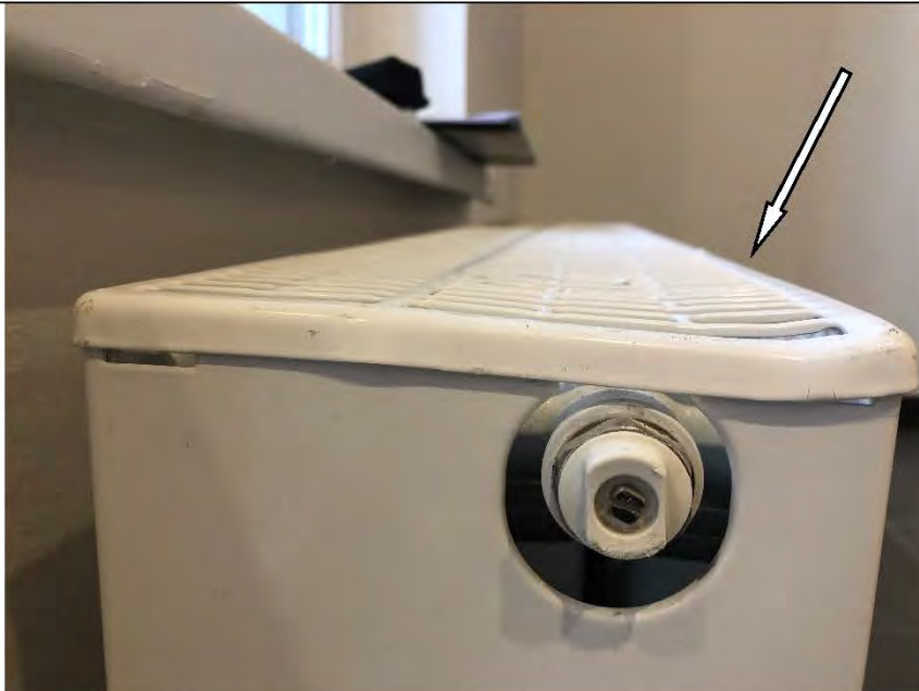
Фото №46. Дефект на кожухе отопительного прибора в кухне в квартире.
