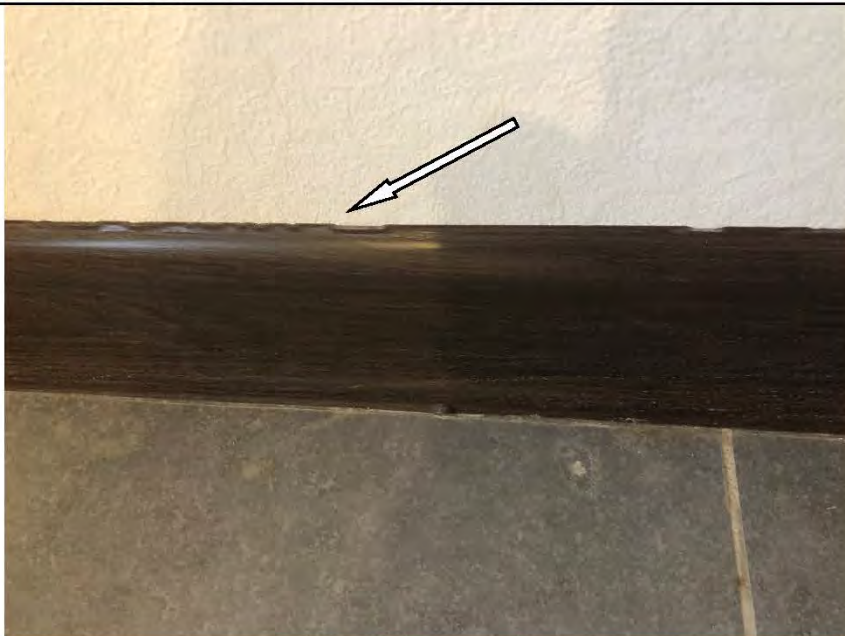
Фото №26. Изогнутость напольного плинтуса ПВХ в кухне в квартире.
