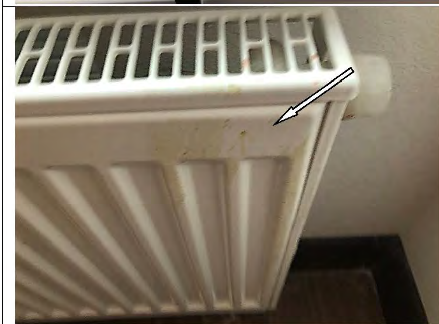
Фото №60. Загрязнение на кожухе отопительного прибора в квартире.
