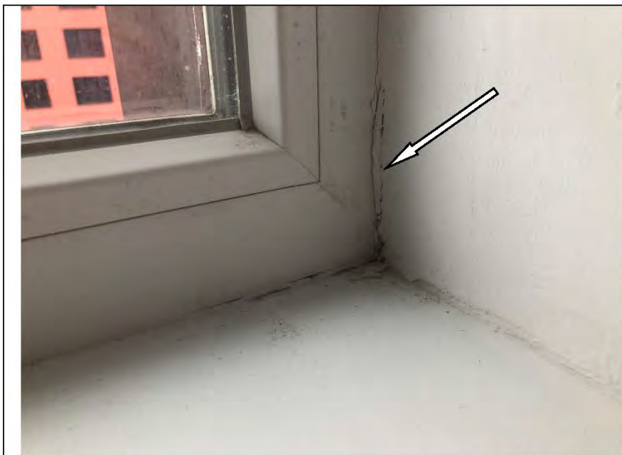
Фото №61. Трещина (щель) в месте примыкания оконного блока в спальне в квартире.
