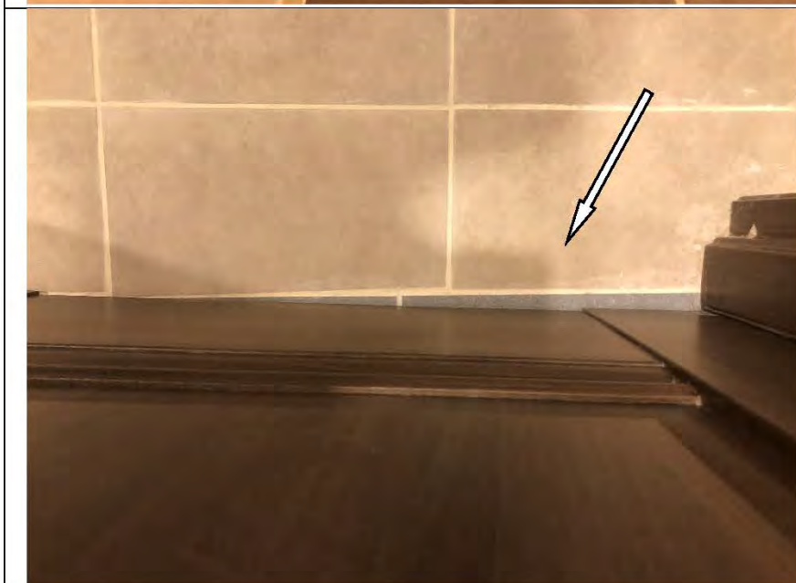
Фото №39. Дефект уровня пола. Уровень пола в ванной комнате равен уровню пола в коридоре.
