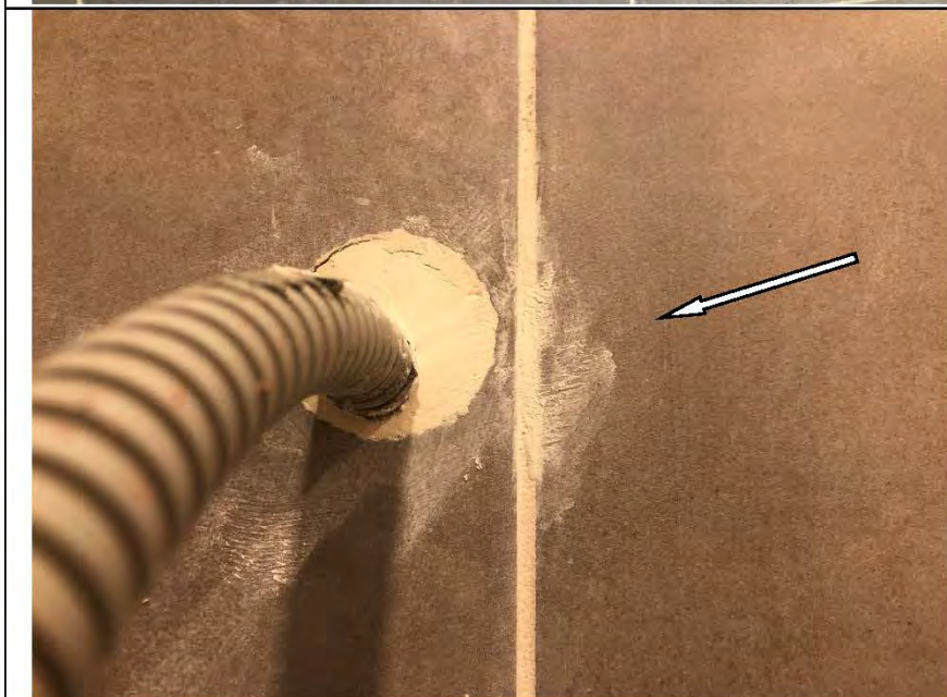
Фото № 35. Загрязнение настенной керамической плитки в ванной комнате в квартире.
