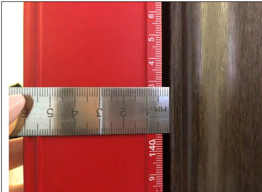
Фото №13. Отклонение наличника деревянного дверного блока в кухне в квартире.
