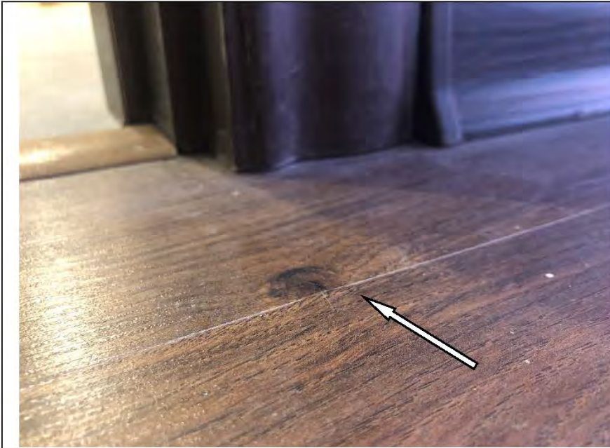
Фото №64. Приподнятые кромки ламината в спальне в квартире.
