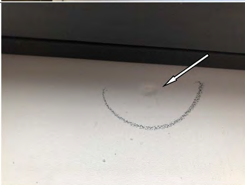
Фото №48. Вмятина на подоконной доске на лоджии в квартире.
