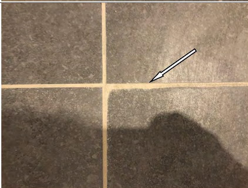
Фото № 27. Неровный шов напольной керамической плитки в коридоре в квартире.
