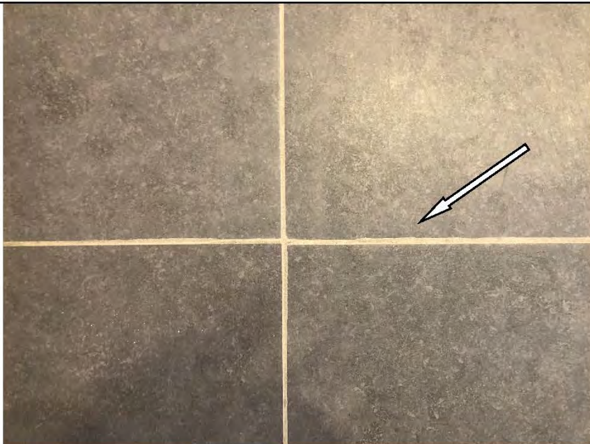
Фото № 29. Неровный шов напольной керамической плитки в кухне в квартире.
